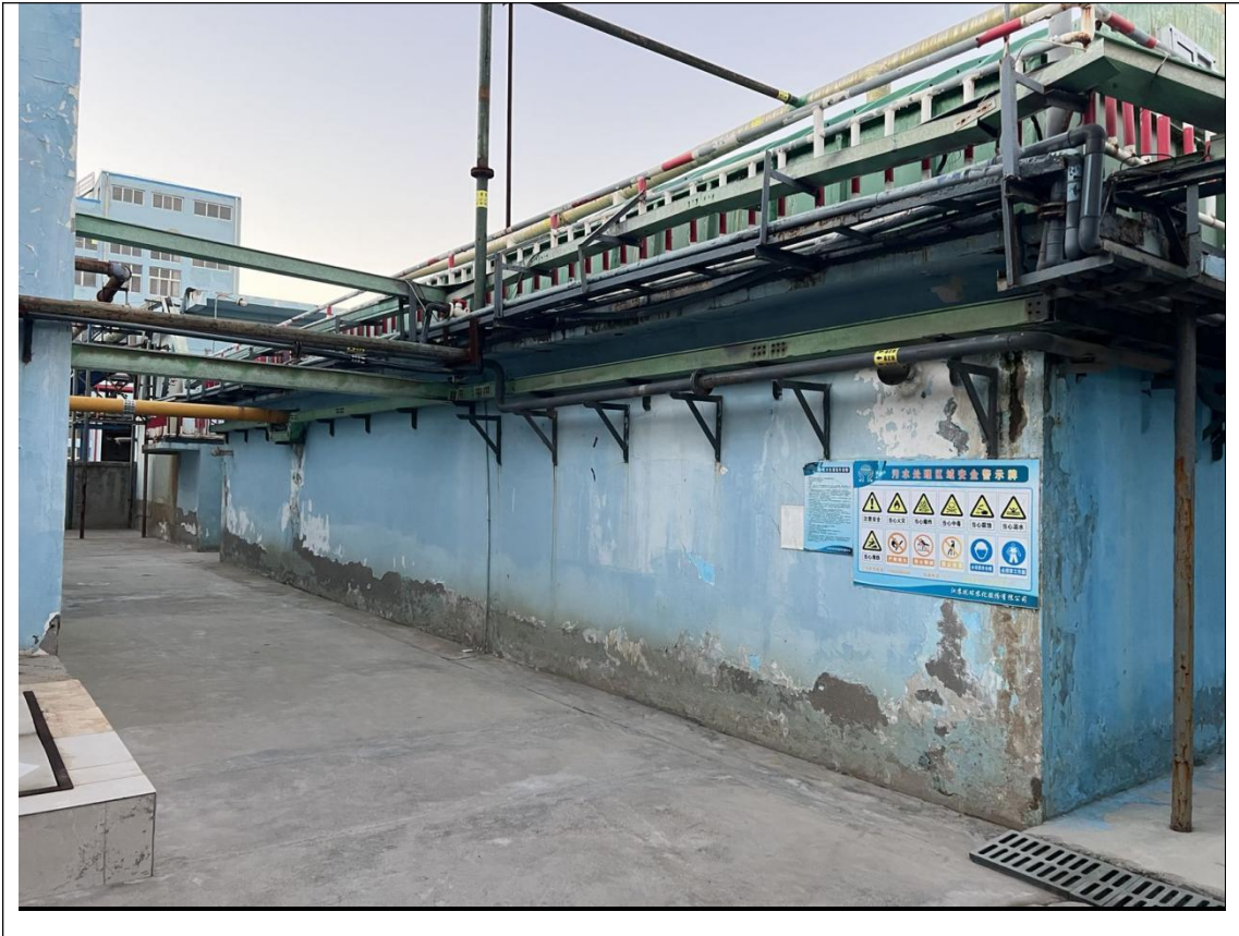
图 4-2 污水处理设施现场情况
